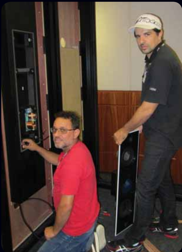
Niro e Osmar instalando sistema de cinema B&W, com todas as caixas acústicas embutidas em parede falsa, na madrugada do dia 18 de março
